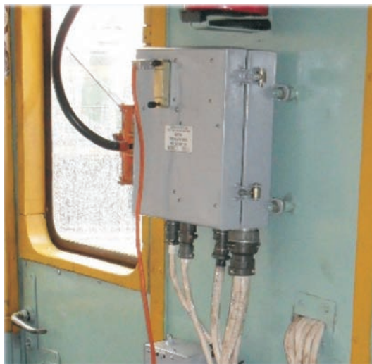
Рис. 16. Размещение электронного блока управления системы СУДМ.03 в кабине машиниста тепловоза ТЭМ2
