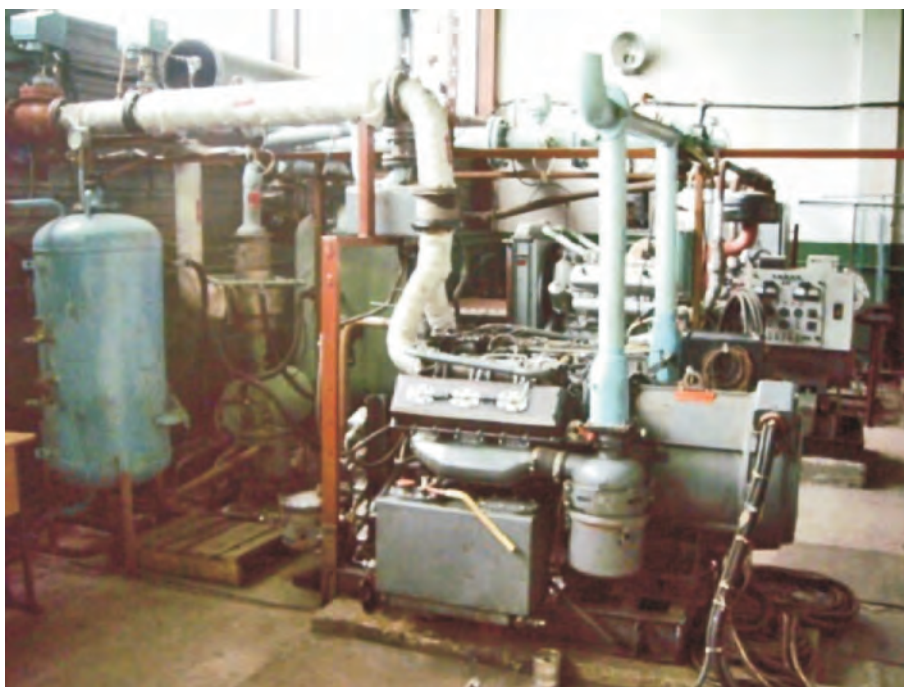
Рис. 3. Экспериментальный образец воздухонезависимой энергетической установки мощностью 100 кВт на базе дизеля 6Ч 15/15
