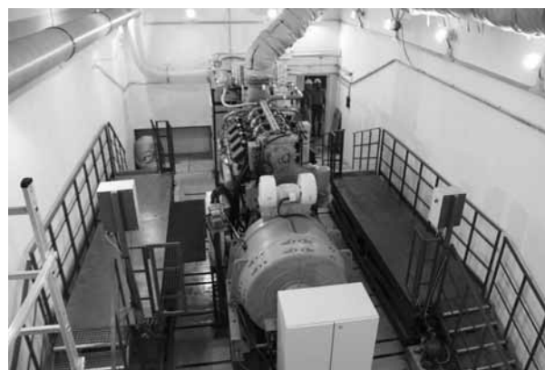
Рис. 3. Испытательный стенд с установленным газовым двигатель-генератором
