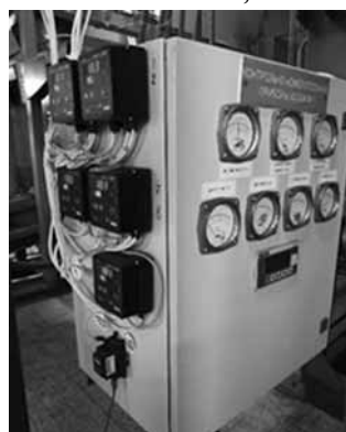
Рис. 5. Щит КИП с терморегуляторами
