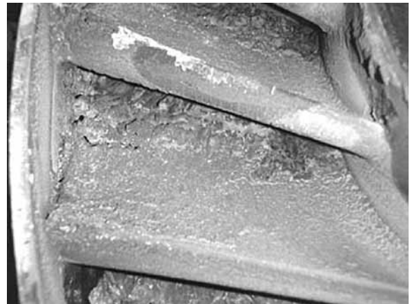
Рис. 17. Грязевые отложения на сопловых лопатках
